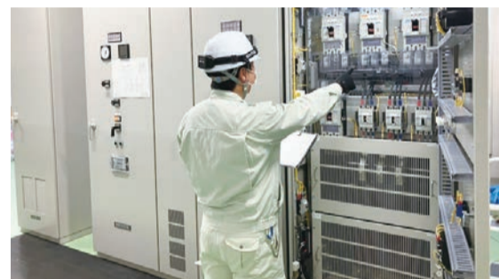
▲(電気職) 電気室の配電盤に異常がないか点検や調査をしています。
