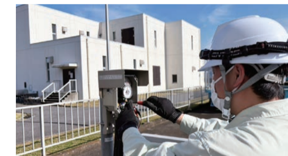
▲(電気職) 計器に不具合があった場合、職員が対応をしています。
